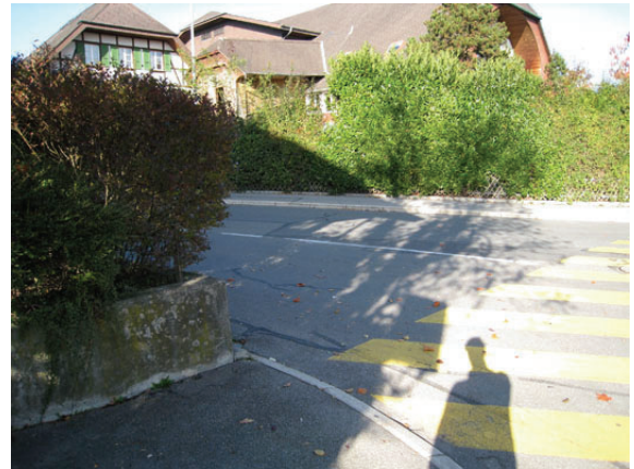
Schlechte Sichtverhältnisse für wartende Zufussgehende
